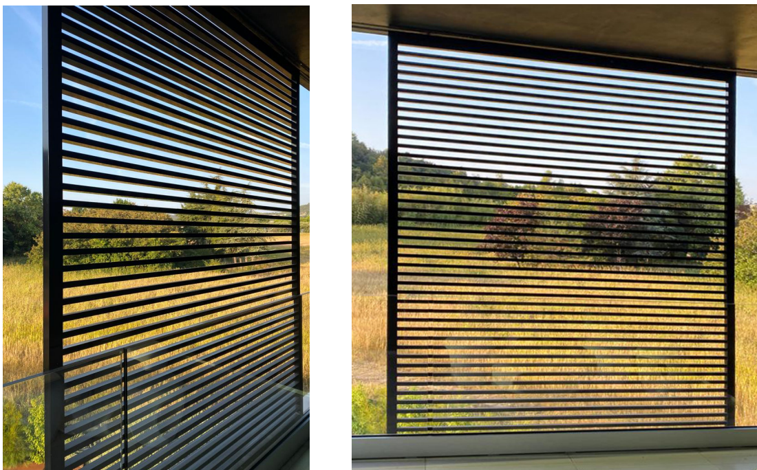
Sistema di oscuramento – profili tipo Metra come da dimensioni riportate nella relazione.
