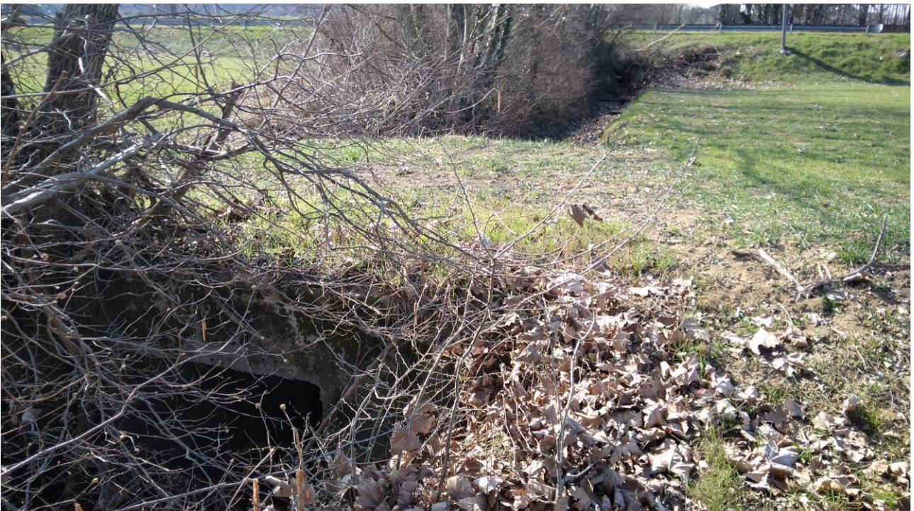
Vista da valle del manufatto 1.60x1.60m parzialmente occluso [107-108]
