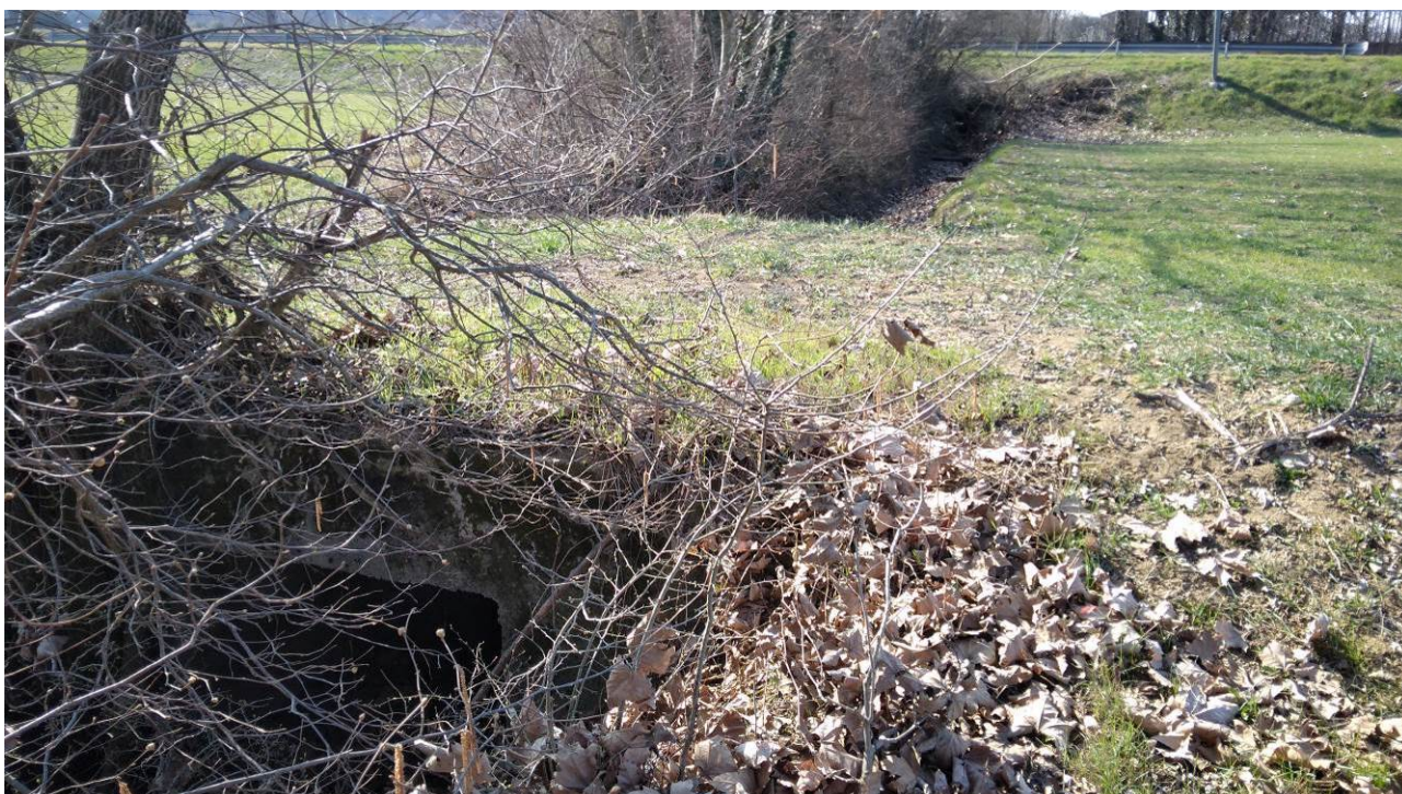
Vista da valle del manufatto 1.60x1.60m parzialmente occluso [107-108]
